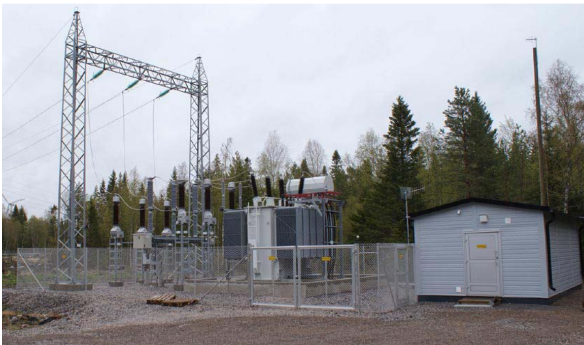
Figur 6-8 Exempel på en elstation.
